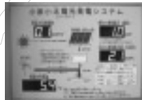
発電量を表示するパネル
