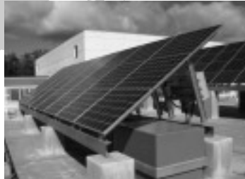
北見市立小泉小学校のソーラーパネル
